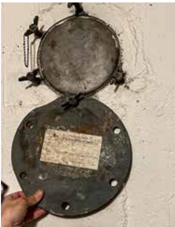
Luftuttag med järnplatta.
