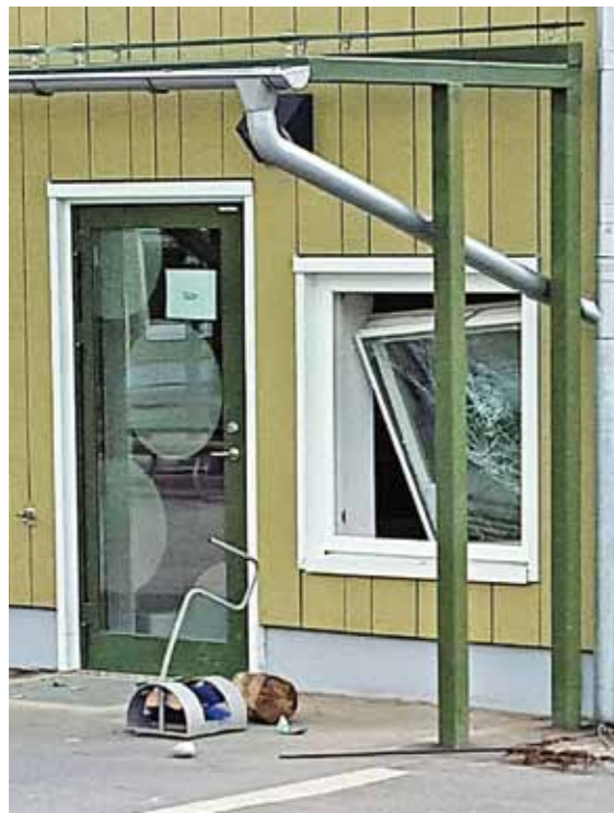
Den tunga skoborsten kastades in i fönsterrutan
